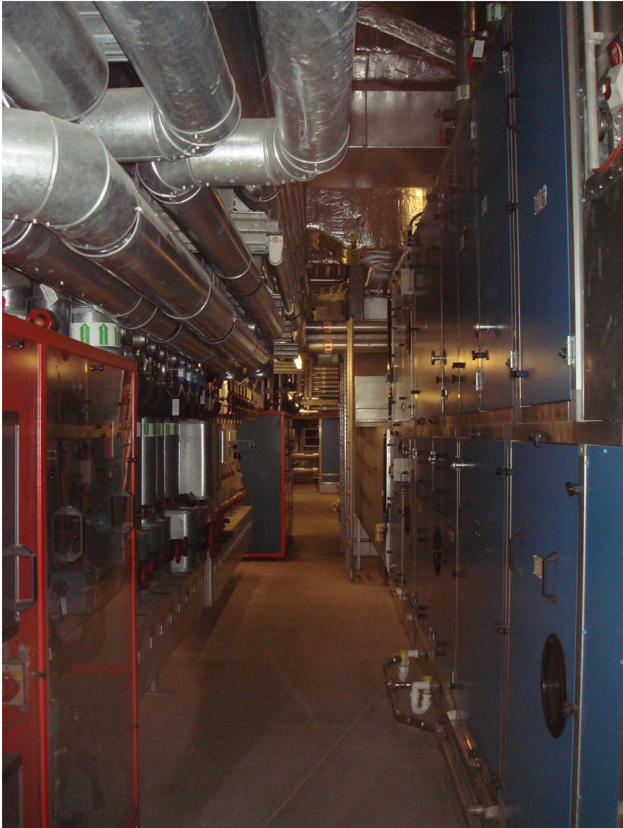
Abb. 7: Wirkprinzipprüfung / Vollprobetest – VDI 6010 Blatt 3 weist einen Weg zur erfolgreichen Anlagenprüfung, der trotz Ecken und Kanten nicht in einer Sackgasse endet
